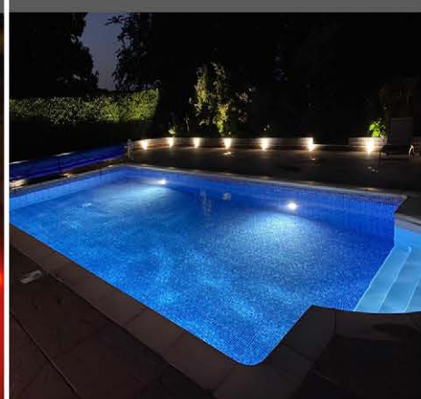
نصب در دیواره استخر بصورت روکار
